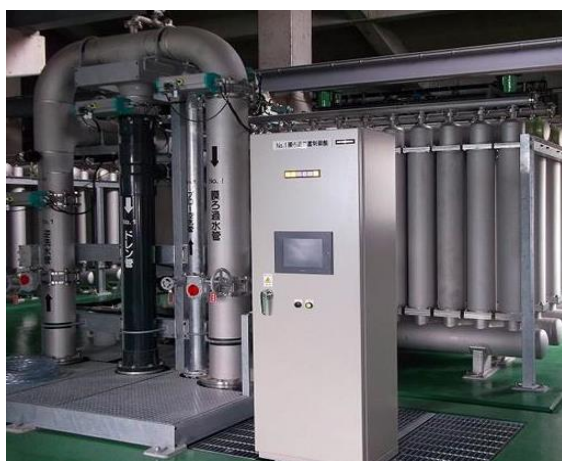
山本浄水場（膜ろ過室）
