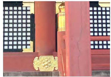
地震でひび割れた宇佐神宮本殿 (令和 4 年)
