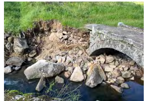
台風で崩落した念仏橋と護岸 (令和 4 年)
